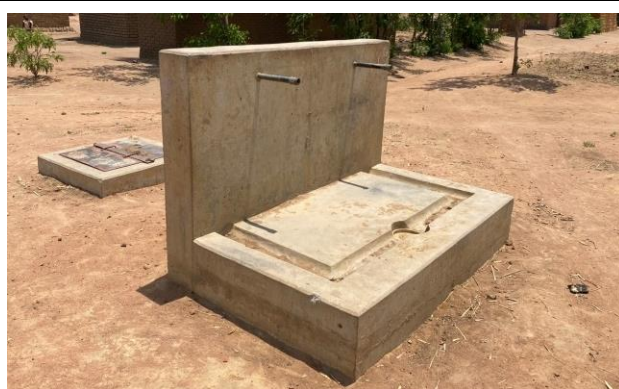
使用されていない公共水栓
