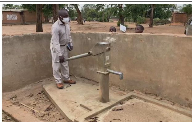
故障したまま放置されているハンドポンプ井戸
