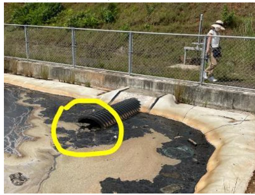
新規処分場浸出水調整池の集排水管閉塞 の可能性あり
