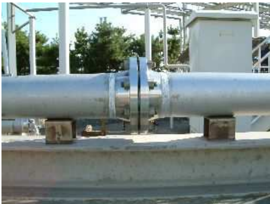
Receiving pipe for LNG
