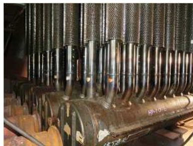
Tubes inside HRSG
