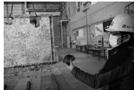
内部モルタルの破片
