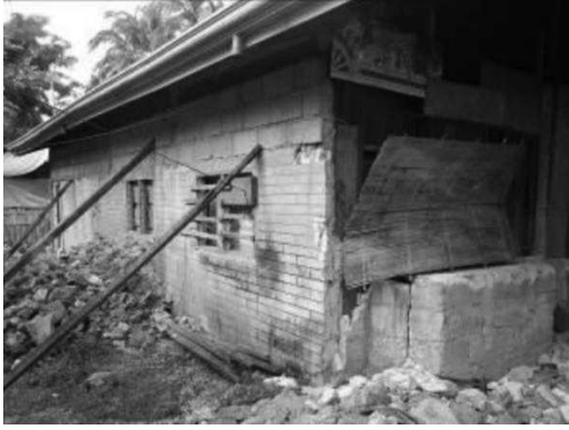
写真1 大破したコンクリートブロック造の戸建て住宅
