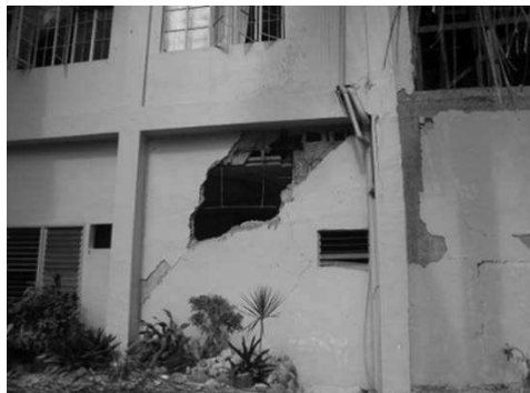
写真 3 構造壁の外壁が崩壊した庁舎
