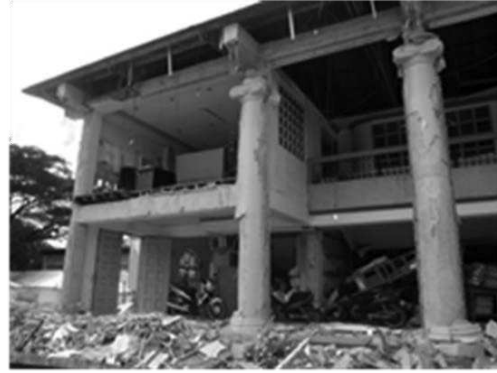
写真2 コンクリートブロック造の外壁が倒壊した庁舎
