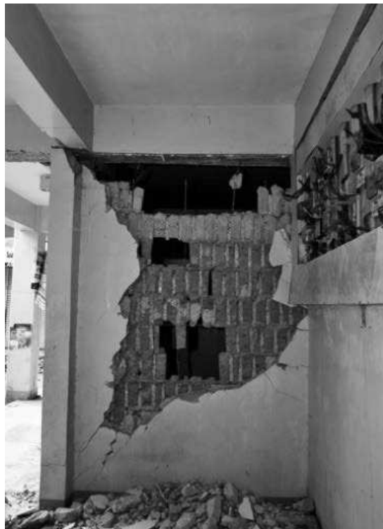
写真 5 構造壁のコンクリートブロックの表面部分（フェースシェル）が剥落した事例（仕上げ材が剥離した部分では、充填されたモルタルが残存している）
