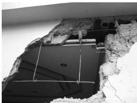
写真 4 コンクリートブロックの非構造材が破壊、落下した部分。補強の鉄筋と、充填されていたモルタルの一部が残っている
