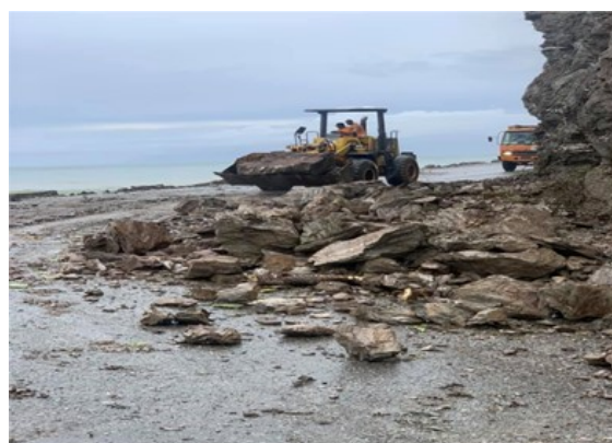
2021年4月洪水時のがけ崩れ現場における、IGEが所有するホイールローダーを用いた道路啓開作業
