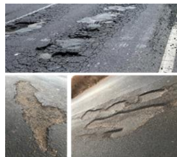
写真 道路損傷の様子 (ダカール州内 国道 1 号線上) (再掲)
