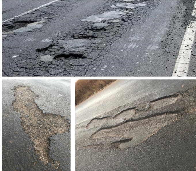
写真 道路損傷の様子（ダカール州内 国道1号線上）
