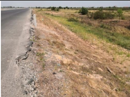
国道5号 シソポンバイパス (開通前に路肩が既に損傷)
