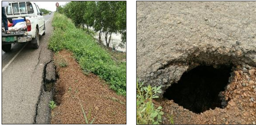
図 1-1 ドラゴンホールによる道路損傷状況
