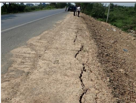
適合性施工1ヵ月後 (シート無し部分にクラック)
