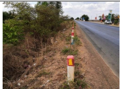
国道6号 94キロポスト (路肩にひび、杭が傾斜)
