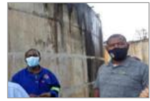
水槽損傷状況確認
