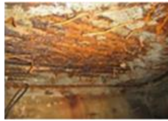
橋脚台内部剥離
