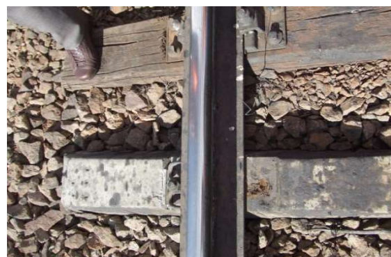
過大な横圧荷重により締結ボルトが折損している
