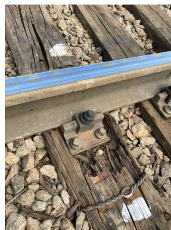
急カーブ区間木製枕木の破損状態(35 エリア)
