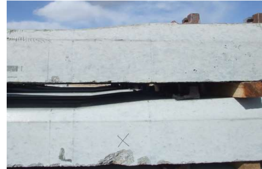
部分的に欠けている枕木が強度に影響する ため本線で使用しないよう指示した
