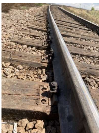
急カーブ区間締結装置の浮き上がり
