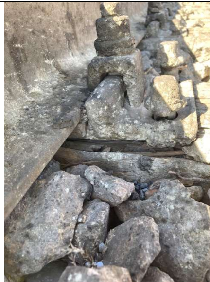
鋳鋼製の他社締結装置(ねじが浮き危険)
