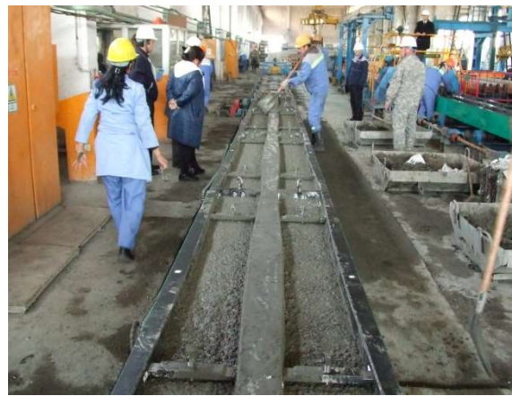
コンクリートの注入量を調整する最終作業 (バイブレーションで平滑にされる)
