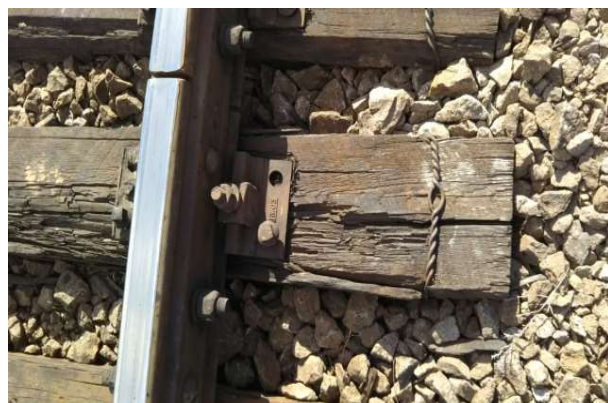
ねじ釘外れ、木の枕木が割れている
