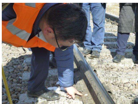
白マーカーは要点検箇所を示している
