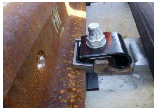
装着された M-01 締結装置
