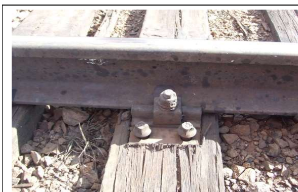
ねじ釘が緩んでレールが浮いている
