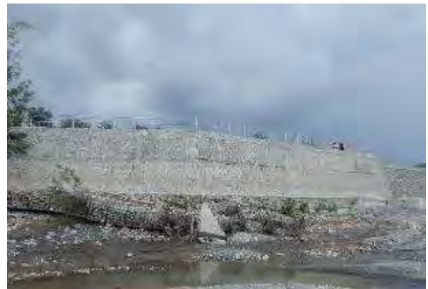
図 3.4-6 練石積護岸の基礎部洗掘状況写真
