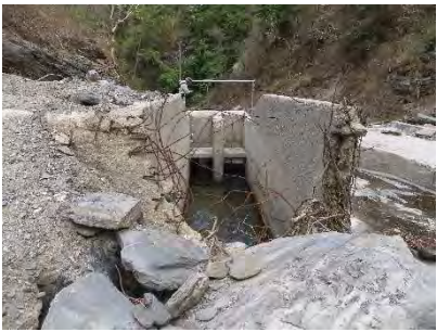
頭首工：のり面上からの落石により豎壁、翼壁が破壊された。
