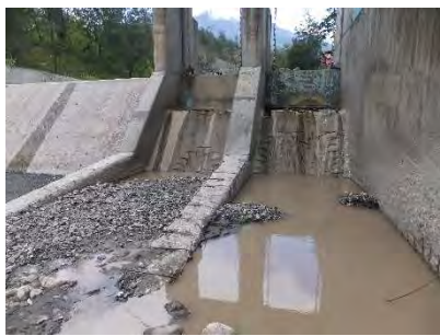
マリアナ灌漑 土砂吐工：摩耗により鉄筋が露出。
