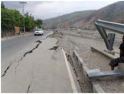
右岸 4.1km 付近：擁壁護岸が崩れ河岸上の道路の一部が崩落。
