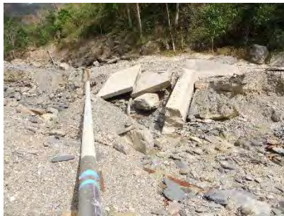
第1 河川横断工：左岸側取り付け護岸を除いて壊滅的に破壊。
