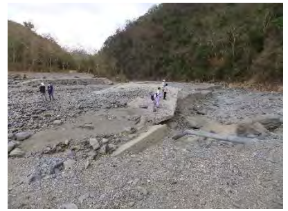
第2 河川横断工：洪水流が右岸高水敷を流下。右岸側取り付け護岸が被災。
