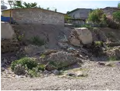
左岸 0.9km 付近：被災区間の一部は空港滑走路に近接している。
