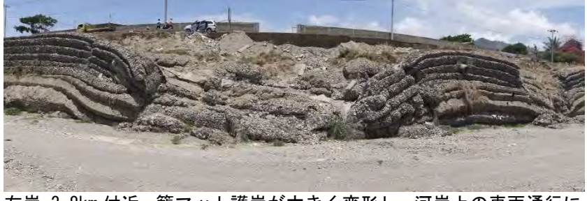
右岸 3.8km 付近：籠マット護岸が大きく変形し、河岸上の車両通行に支障を及ぼしている。
