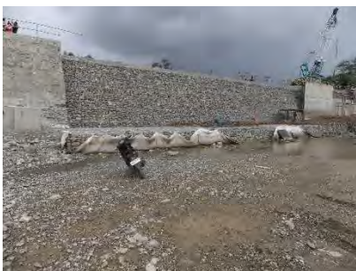
ブルト灌漑 土砂吐き下流右岸：練石積み護岸が倒壊。籠マットで応急復旧済み。
