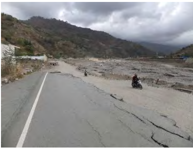
右岸 5.5km 付近：護岸が崩れ、河岸上道路が崩落。
