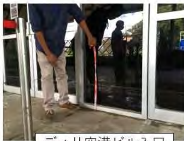
ディリ空港ビル入口 建屋内で被害発生
