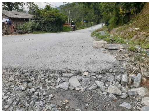
現地道路損傷状況 (未補修)
