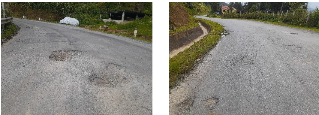
図1 現地道路損傷状況（ポットホール・ひび割れ）
