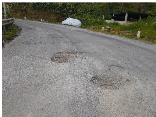
現地道路損傷状況 (ポットホール)
