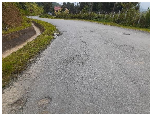
現地道路損傷状況 (ひび割れ)
