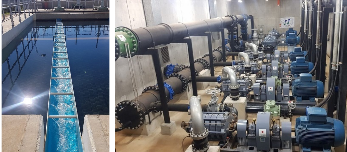
新浄水場の浄水施設(左)とポンプ施設(右)
