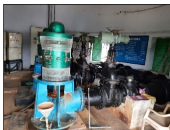
ポンプ施設 (Tiruchirappalli)
