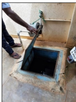
地下貯水用タンク
