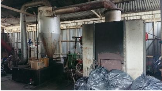
破損した医療廃棄物用焼却炉 (ウェワク)
