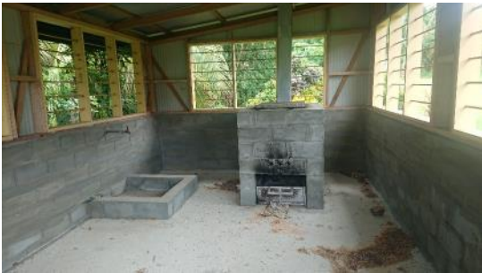
医療廃棄物処理用に作られた焼却炉だが、レンガに ひびが入り使えなくなった (マダン)
