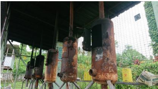
現地で製造された医療廃棄物用焼却炉。破損個所が 多い (ココボ)
