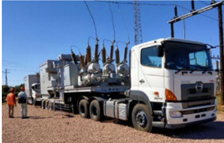
図 5.2-2 移動用変電所例
