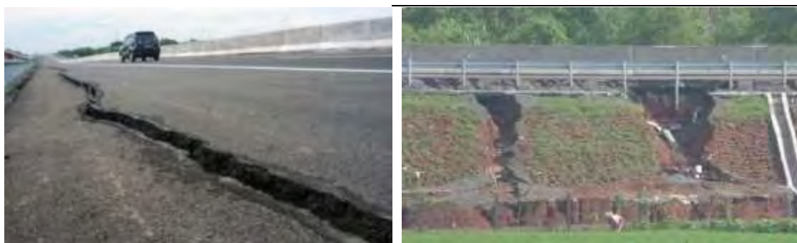
写真2 Pemalang - Batang 高速道路に発生した亀裂及び盛土すべり
