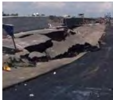
写真1 Palembang - Indralaya 高速道路の陥没
