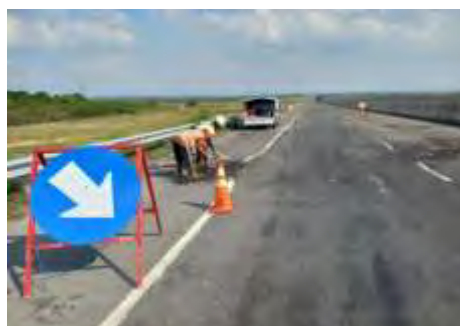
写真3 Terbanggi Besar - Kayu Agung 区間の湾曲・凹凸
