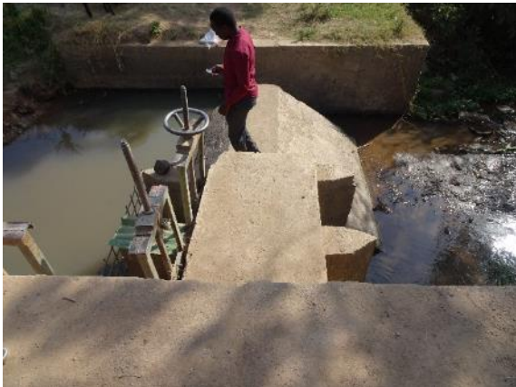
Igurusi 農業研修所 (MATI) の圃場への灌漑用水を取り入 れるための取水堰
