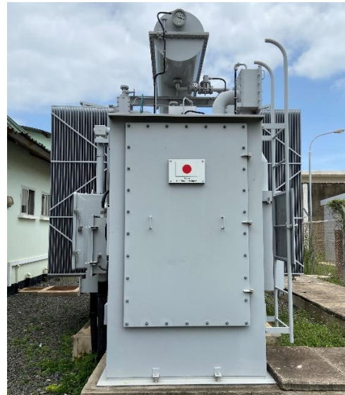
33/11kV 変圧器（ムササニ変電所）
