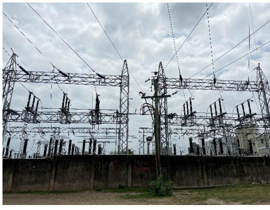
132kV 送電線ガントリー（イララ変電所）
