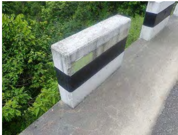
シンズリ道路 盗難破損状況
