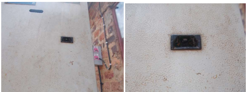
破壊された公共水栓 PPWM (カンパラにて)
