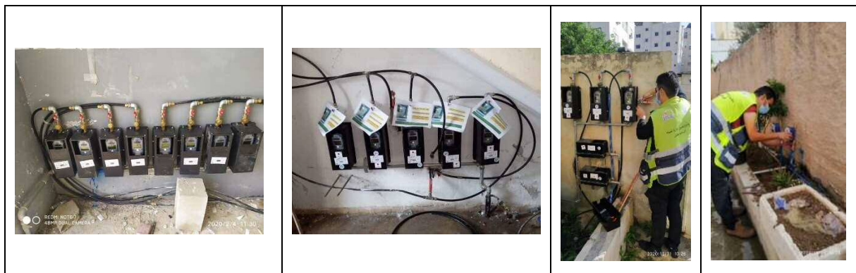
写真 6. PPWM の設置状況
