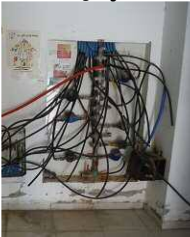
صورة 6.6 وجود مكان لتركيب عدادات دفع المسبق .
