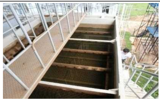
第1回渡航 2019年6月26日 ドンバン浄水場 高速沈殿槽
