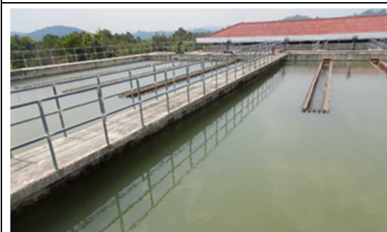
第5回渡航 2020年3月10日 シェンクワン県 浄水場
