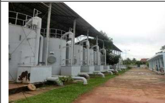
第1回渡航 2019年6月26日 ドンバン浄水場 ろ過装置
