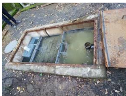
エクセラ村設置 DMR の状況
