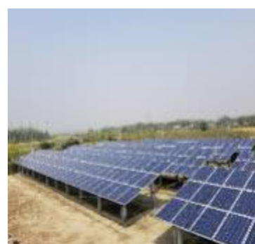
Solar Power Mini-Grid
