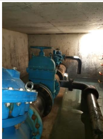
無償事業で整備した配水本管と減圧弁
