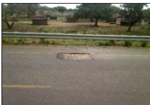
ポットホール (エレグから 10km 地点)
