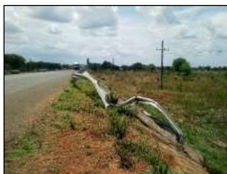
損傷したガードレール (エレグから 4.6km 地点)
