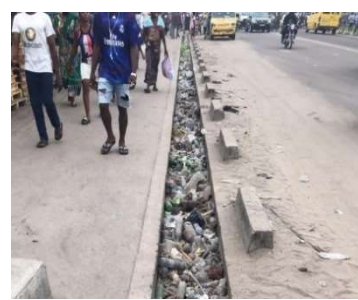
ゴミで埋まっている側溝
