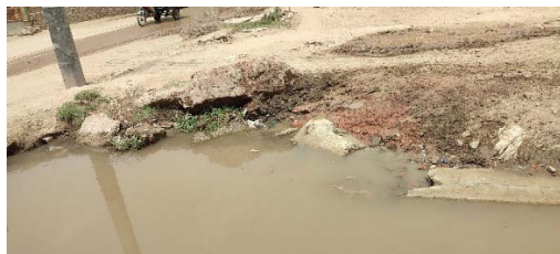
図 9 側堤の保護工が破損している Tulwala 三次水路
