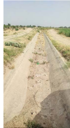
図 8 灌漑用水が供給されていない三次水路 (Minor)
