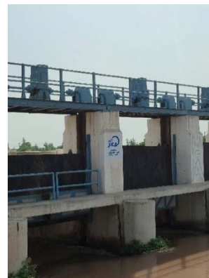
図 10 Burala 二次水路のケーブルが破損した水位調整施設
