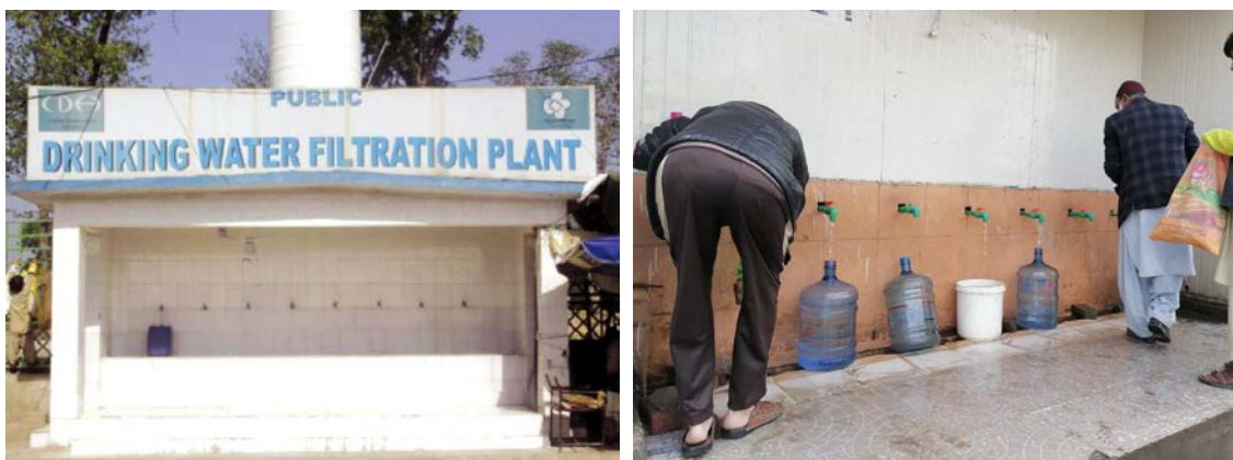
パキスタン側負担で建設されたヒ素除去施設
