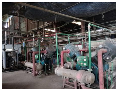
写真1 工業用酸素製造設備
