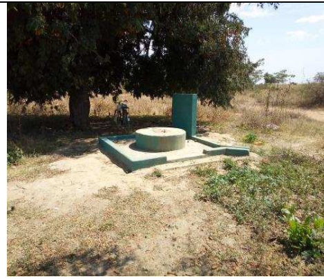
覆いはあるがポンプのない浅井戸
