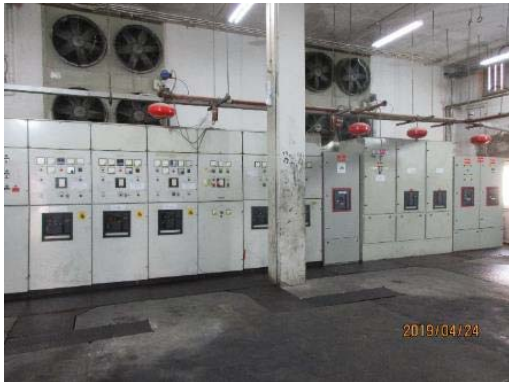
電気コントロール室
