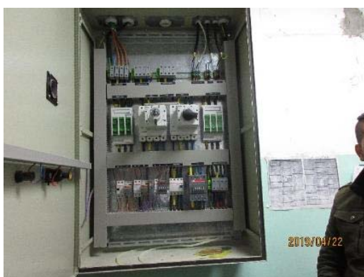
停電時発電機自動発停装置
