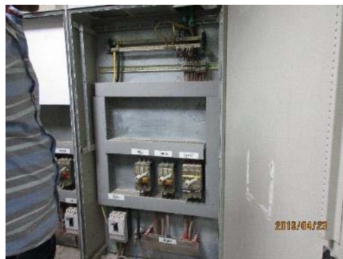
MRI への電源供給用ブレーカー（スペアあり）
