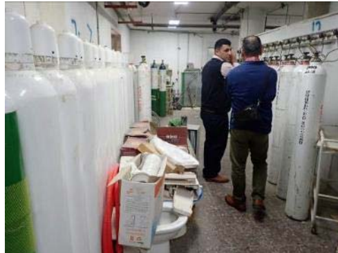
中央酸素供給装置。酸素プラントも整備
