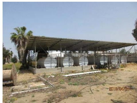
オイルタンク(20,000 リットル x 6 台)
