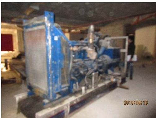
発電機 350KVA (仮置き)
