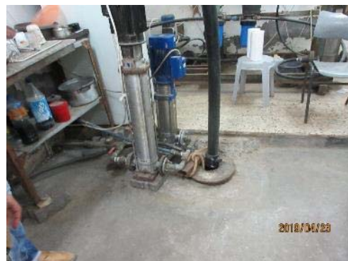
井戸(80m)と揚水ポンプ
