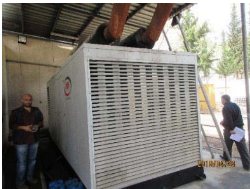
発電機 (1000KVA) 他に 4 台の発電機あり
