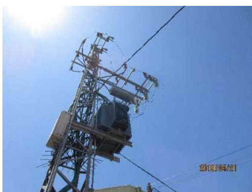
柱上トランス (670KVA)
