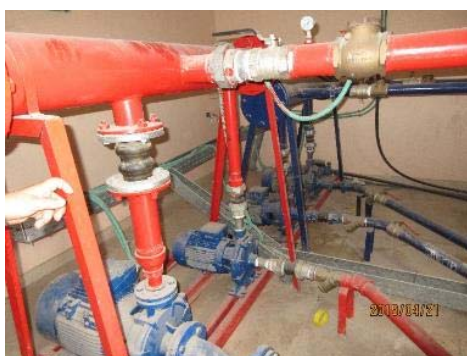
揚水ポンプと消火栓用ポンプ(赤色)
