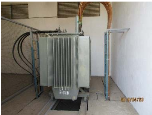
変圧器 (2000Amp 1275KVA)
