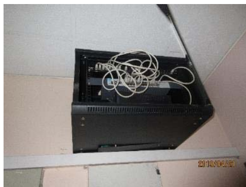
院内廊下に設置された Wifi ルーター
