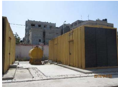
発電機(1275KVA x 2 台)と 4000L のタンク
