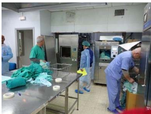
中央滅菌部門 (左滅菌機は故障中)
