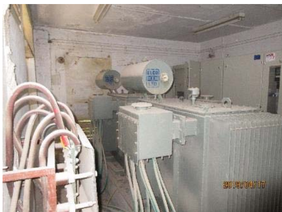
変圧器 630KVA 2台
