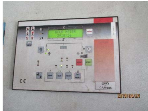
発電機コントロールパネル
