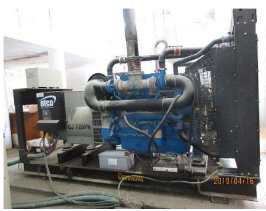
発電機 500kVA と 720kVA
