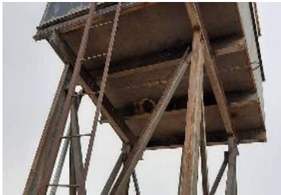
高架タンクの状況(中央ダルフール州：Beja)
