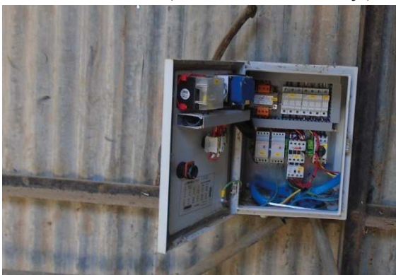
制御盤の状況(西ダルフール州：Margouba)
