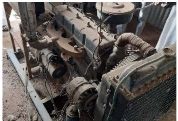
発電機の状況(中央ダルフール州：Beja)
