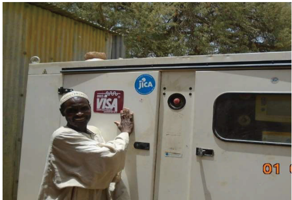
発電機の状況(西ダルフール州：Margouba)
