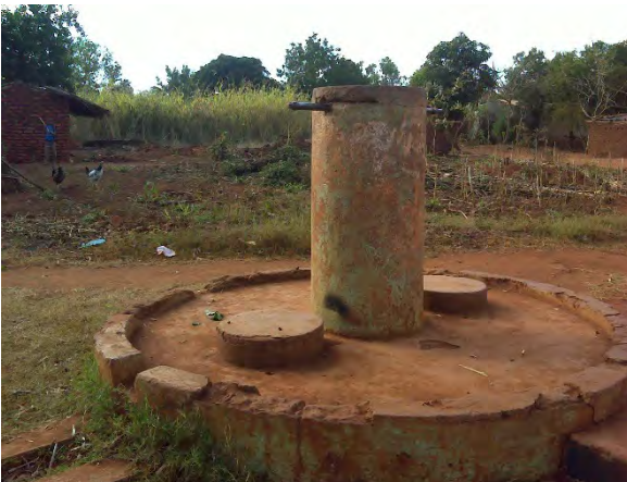
公共水栓 (水栓なし)
