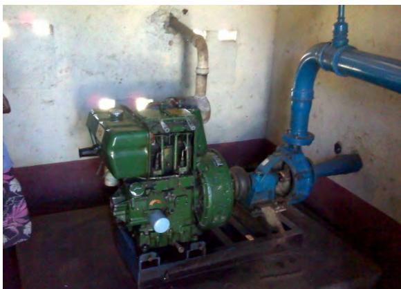
ポンプ室内部 (浅井戸用)
