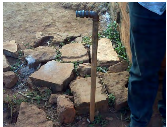
屋外給水栓 (Yard Tap, 水栓なし)
