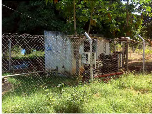
ポンプ室（浅井戸用）
