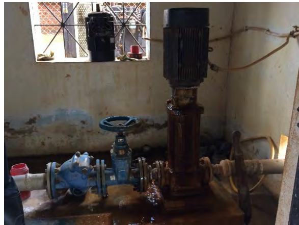
ポンプ室内部（浅井戸用）
