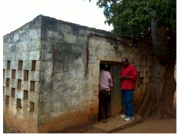
ポンプ室 (浅井戸用)
