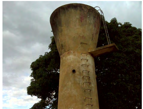
高架水槽 (V=25m 3 )
