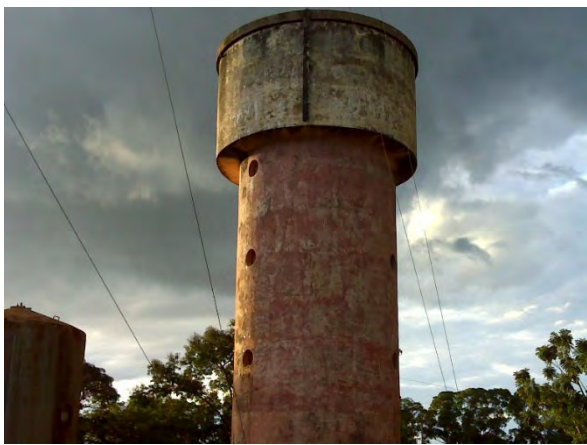
高架水槽 (V=120m 3 )
