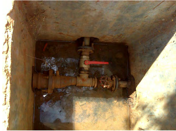
配水区域用バルブボックス
