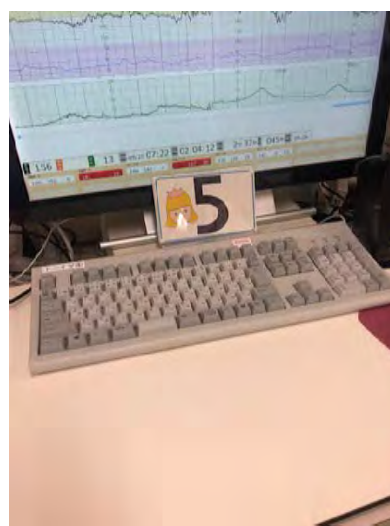
中央監視システム使用例
