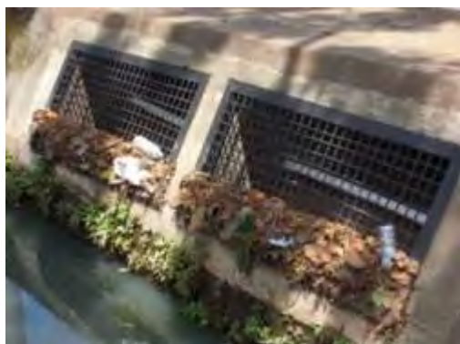
12/18 撮影の流入口（12/17 降雨後）
