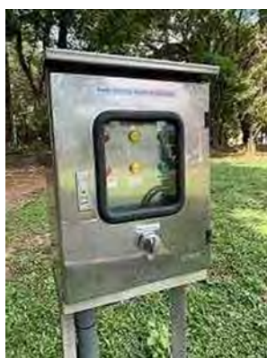
ポンプ操作盤
