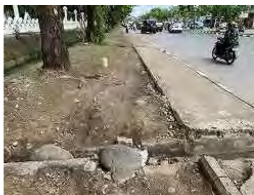
破損したカルバートとバイク通行用の置石
