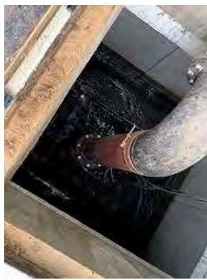
ポンプ排水管
