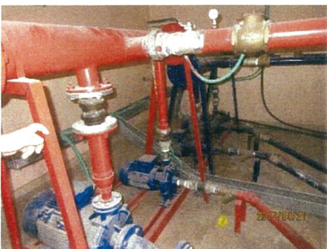
揚水ポンプと消火栓用ポンプ(赤色)
