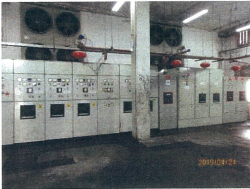
電気コントロール室
