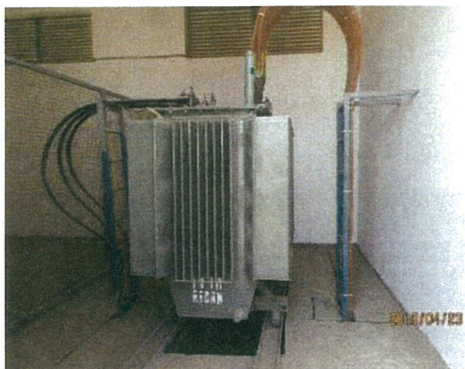
変圧器 (2000Amp 1275KVA)
