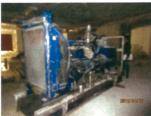
発電機 350KVA(仮置き)
