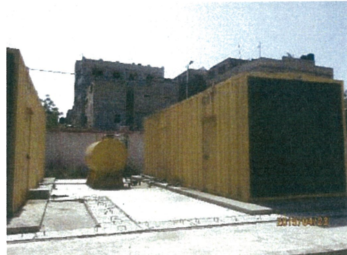
発電機(1275KVA x 2 台)と 4000L のタンク
