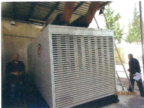
発電機 (1000KVA) 他に 4 台の発電機あり
