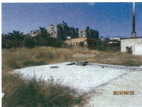
埋設型オイルタンク (60,000 リッター)
