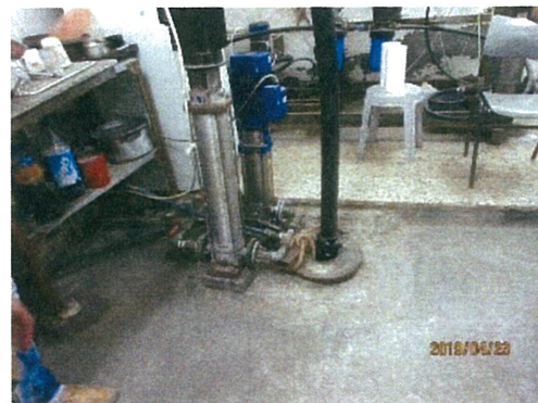
井戸(80m)と揚水ポンプ
