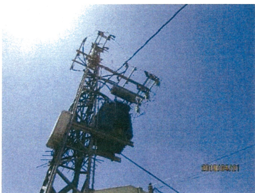
柱上トランス（670KVA）
