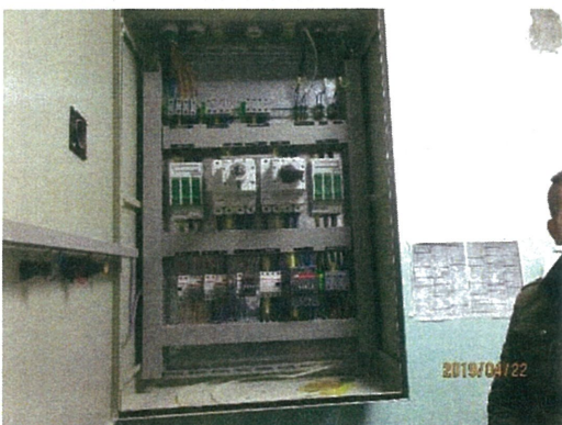
停電時発電機自動発停装置
