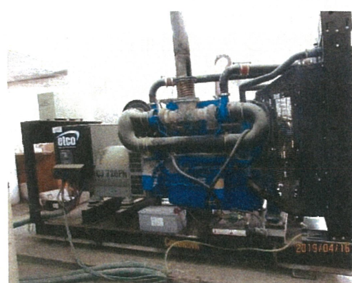
発電機 500kVA と 720kVA
