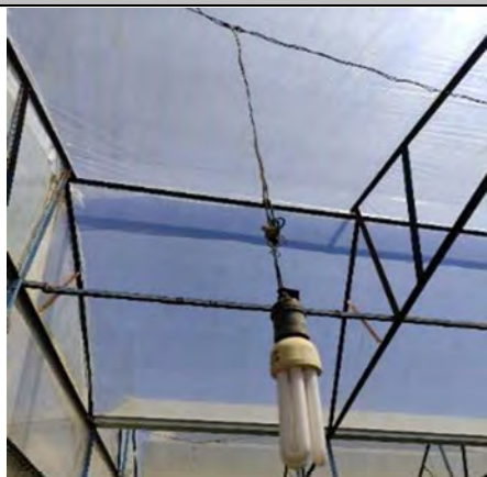
ダラット市内のキク農家で使用される蛍光灯電球。自前で配線工事をしている（ラムドン省ダラット市、2020年11月19日）
