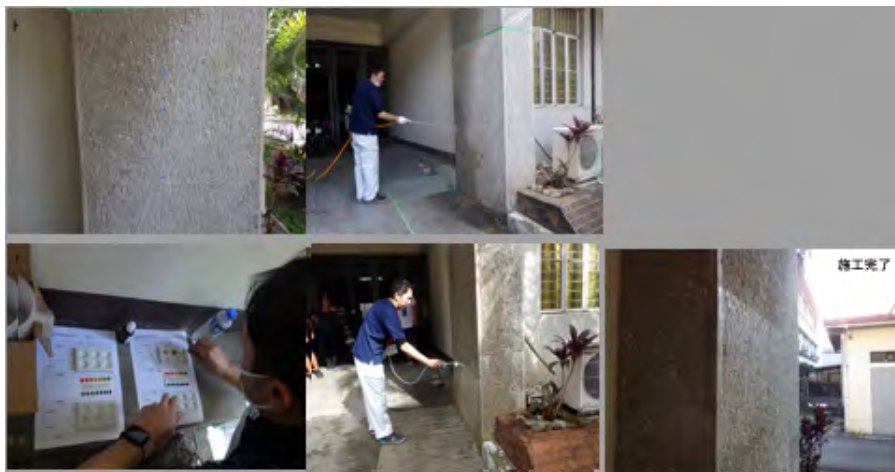
図 10 デモ試験結果（施工部位 1）：表面硬度測定値にはバラツキあり、アルカリ性は保持されていた
