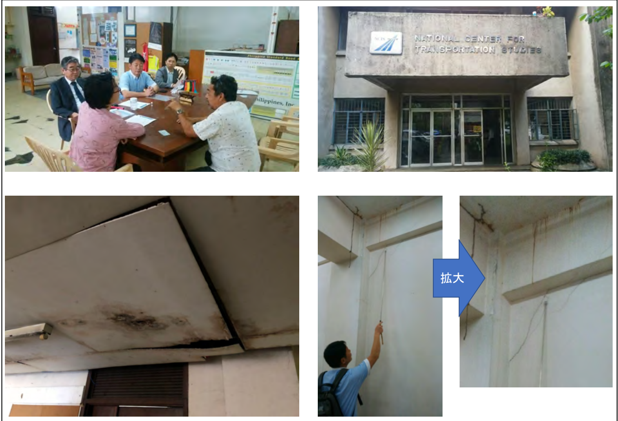
図 6 UPNCT での打ち合わせとひび割れ漏水の現状確認
