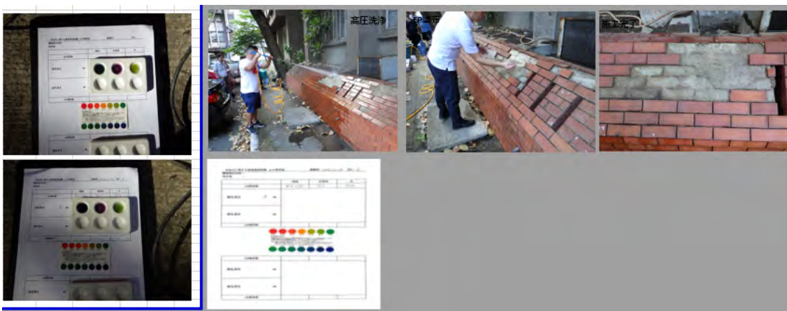
図 12 デモ試験結果(施工部位3):表面硬度測定値にはバラツキあり、アルカリ性は保持されていた
