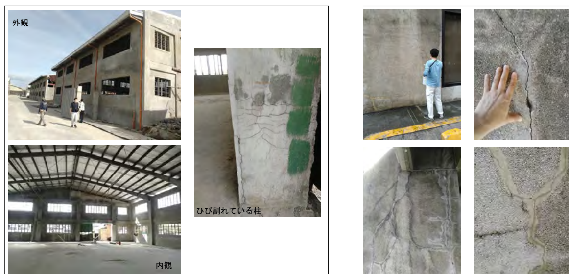
図 18 フィリピンの街中で見かけたひび割れの様子
