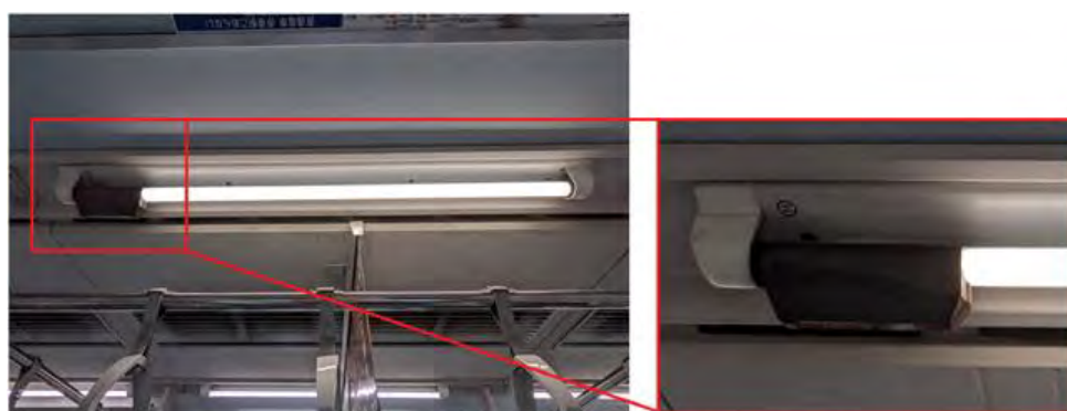
図 8-5 照明一体型防犯カメラ(無線通信機能付き)
