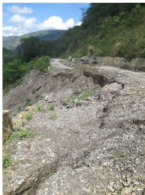
図 35 15.4km 地点の道路破損
