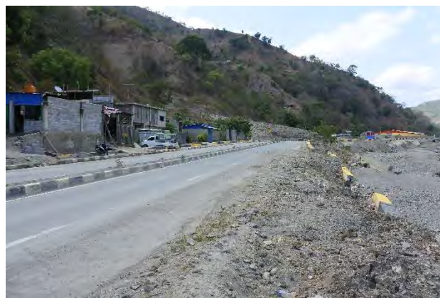
図 32 6.3km(R8)地点の土石流状況
