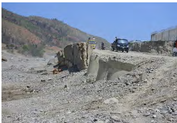
図 31 5.5km(R7)地点の道路破損
