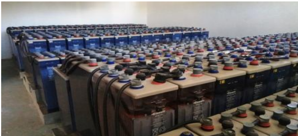
写真 : インドネシアの離島の発電所に放置されている鉛蓄電池 (北スラウェシ州の離島にて)
