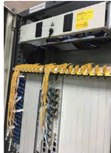
供給者側のブロードバンド回線設備
