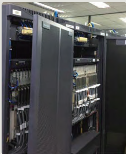
相互接続設備・機器
