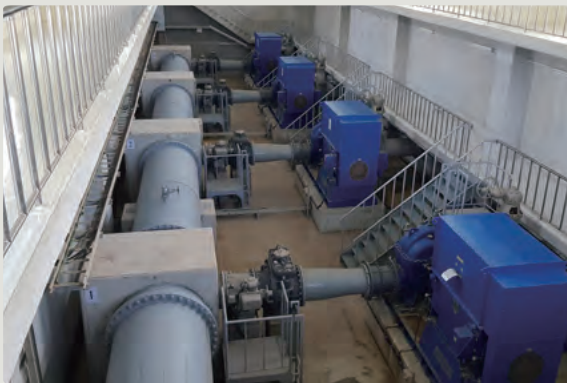
本事業で整備されたニャウフナッピン第一期浄水場送水ポンプ
