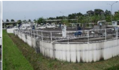
下水処理プラント
