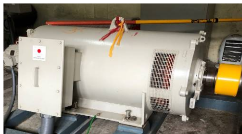
バジャン小水力発電所の発電機
