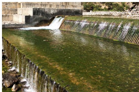
シャルプダハ小水力発電所の取水口
