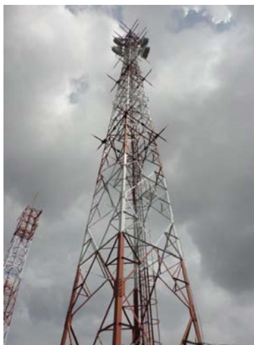
ドマイ VTS センターのレーダースキャナ 及び多重伝送用パラボラアンテナ取付用鉄塔
