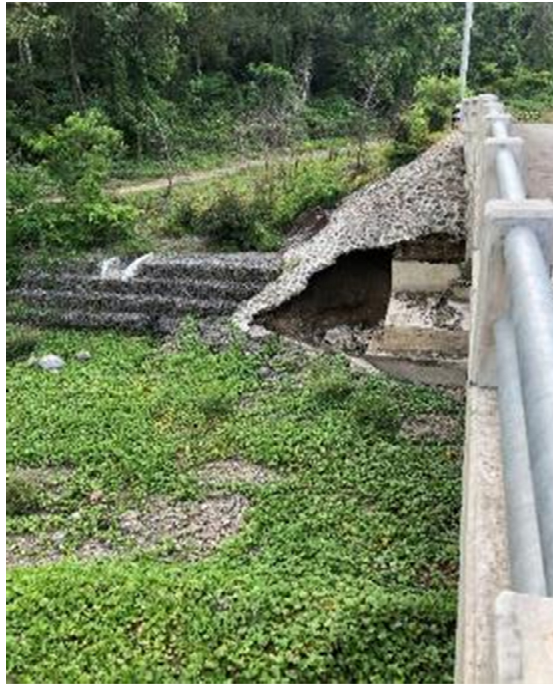
橋台保護工の崩壊（モネI橋）
