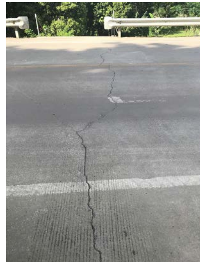
舗装面の亀裂
