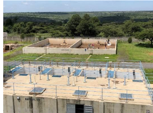
新設北部浄水場 (手前：急速ろ過池、後方：天日乾燥床)
