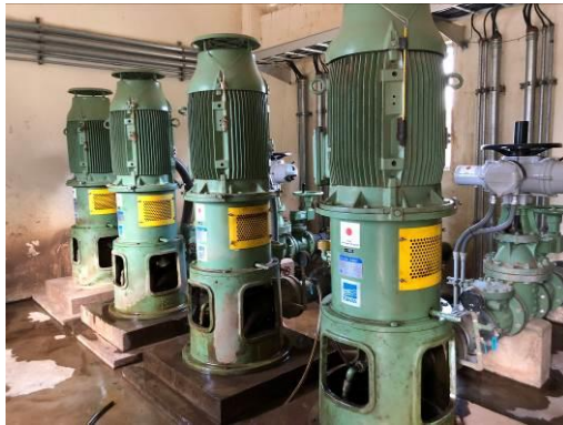
新設された取水施設のポンプ
