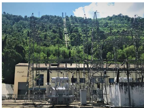
バルーチャン第2水力発電所
