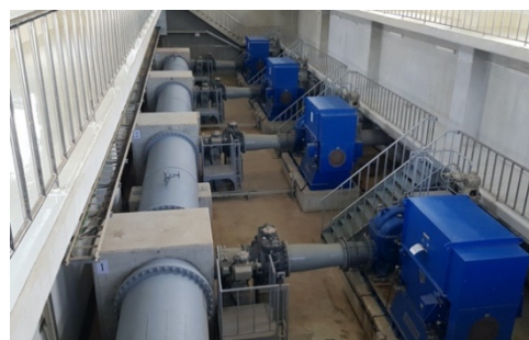
送配水ポンプ（事後評価時）
