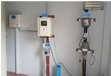
ヤンキンタウンシップに設置された DMA 監視システム用データ記録装置
