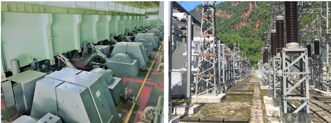
バルーチャン第2水力発電所：発電設備（左）、変電設備（右）
