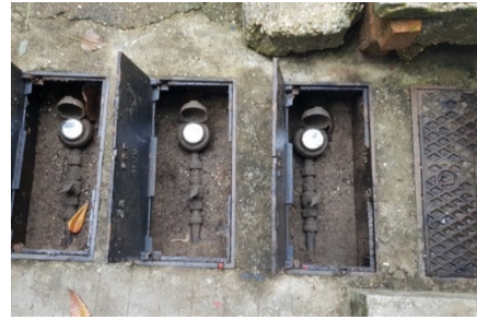
ヤンキンタウンシップに設置された 個別給水用水道メーター
