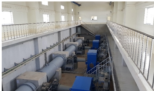
ニャウフナッピン第一期浄水場の送配水ポンプ
