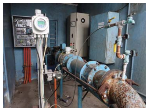
井戸ポンプ場電磁流量計、PLC 盤
