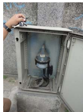
水圧監視点の圧力センサー盤
