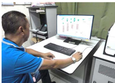
タランバン分庁舎のサブ SCADA 室
