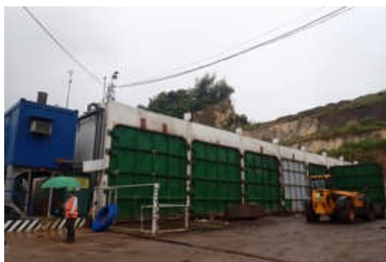
写真 4：廃棄物処理セクター 廃棄物を利用したバイオガス製造施設 （ビサヤ地域セブ）
