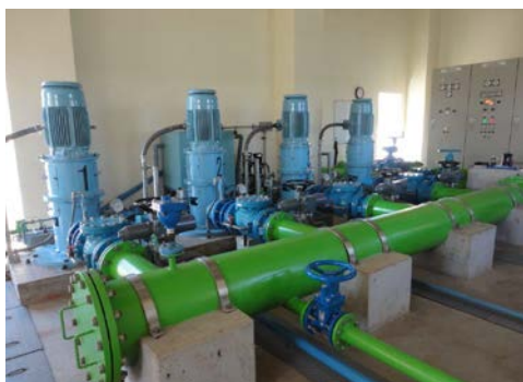
Intake Pump (Kampong Cham)
