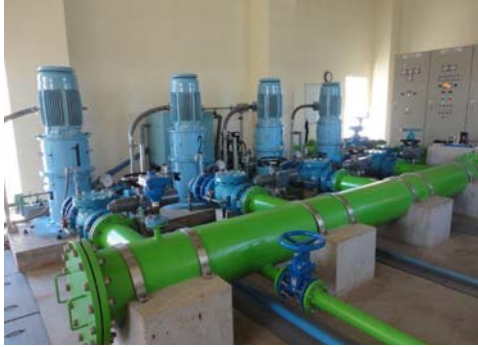
取水ポンプ (コンポンチャム)
