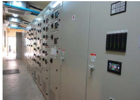
ポンプ場操作室 (バットバン)
