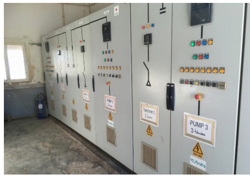
写真 2：アズラックポンプ場の 管理制御システム
