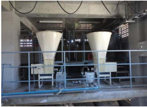
薬品注入設備 (コンポンチャム)
