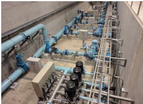
送水ポンプと配水ポンプ (バットバン)
