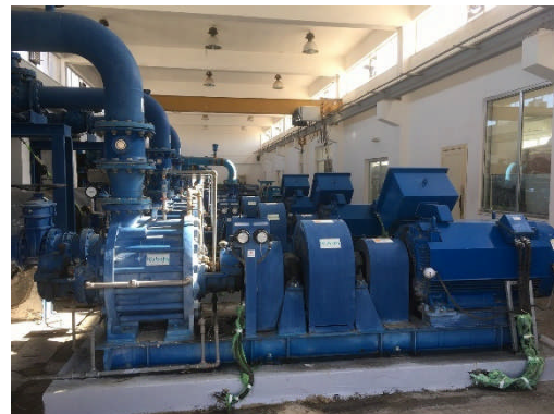
本事業により整備されたポンプ施設 (ザルカポンプ場)
