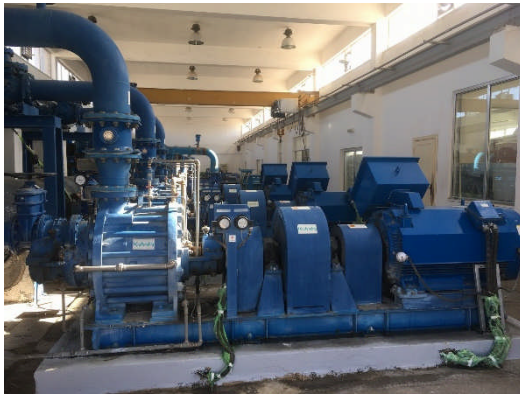
写真 3：ザルカポンプ場のポンプ設備
