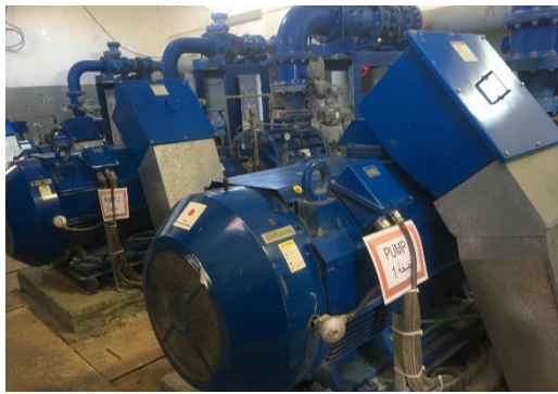
写真 1：ハラバットポンプ場の ポンプ設備
